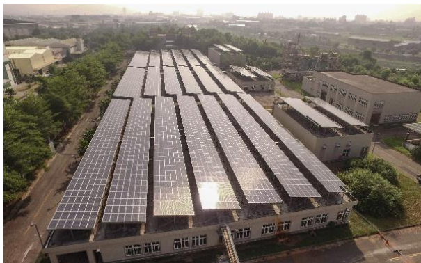
📍 高雄市本洲工業區淨水廠1.4MW
