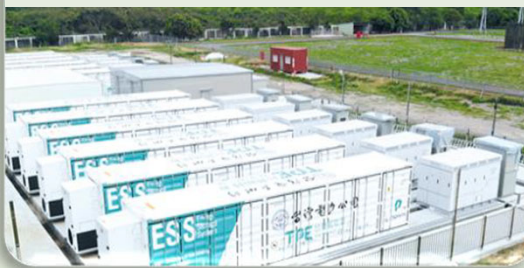
高雄路園變電所(20MW)
