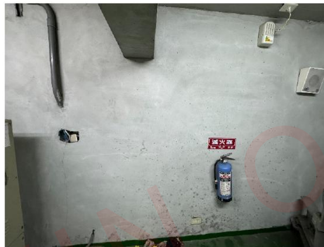
說明: 儲能設備擺放區域
