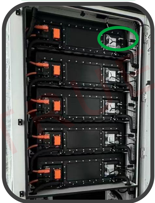
消防連接每個電池
