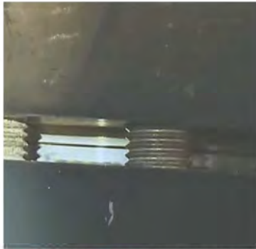
9/10查看GT22天然氣加熱器 下游法蘭接合面縫隙、初判無 墊片殘留
