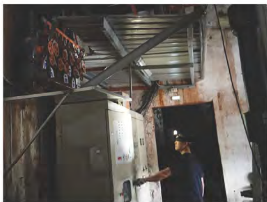
宜蘭縣冬山鄉○○冷凍公司氨氣洩漏事 故(2022)
