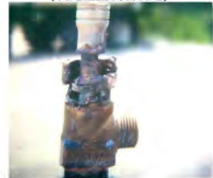
氟氣閥門燃燒 (填充壓蓋洩漏引起)
